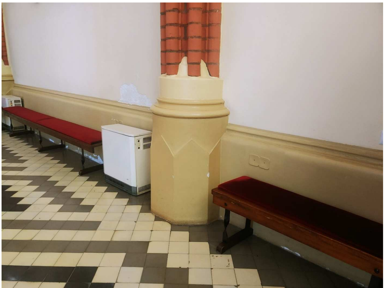
Fot. 8 Miejsce styku posadzki ze ścianą
