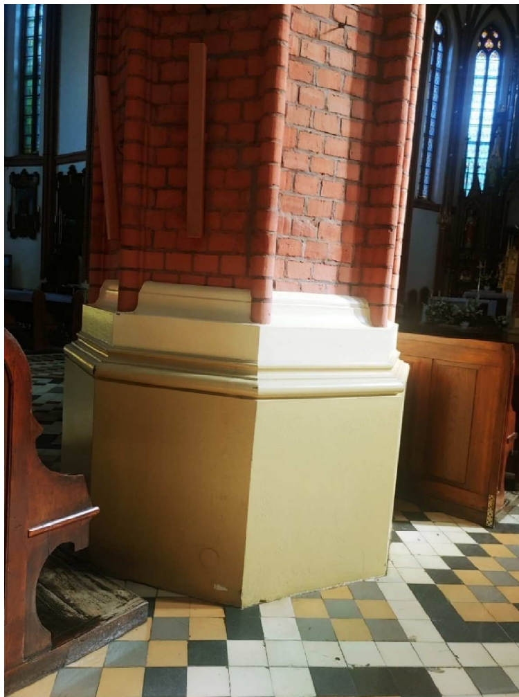
Fot. 9 Miejsce styku posadzki z filarem
